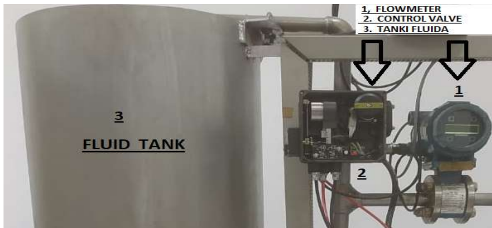
Gambar 7. Instalasi Prototipe Sistem Kendali Cerdas
