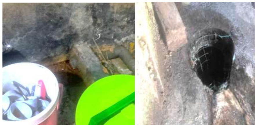
Gambar 7. Tidak terdapat filter pada saluran pembuangan Sumber: Dokumentasi
